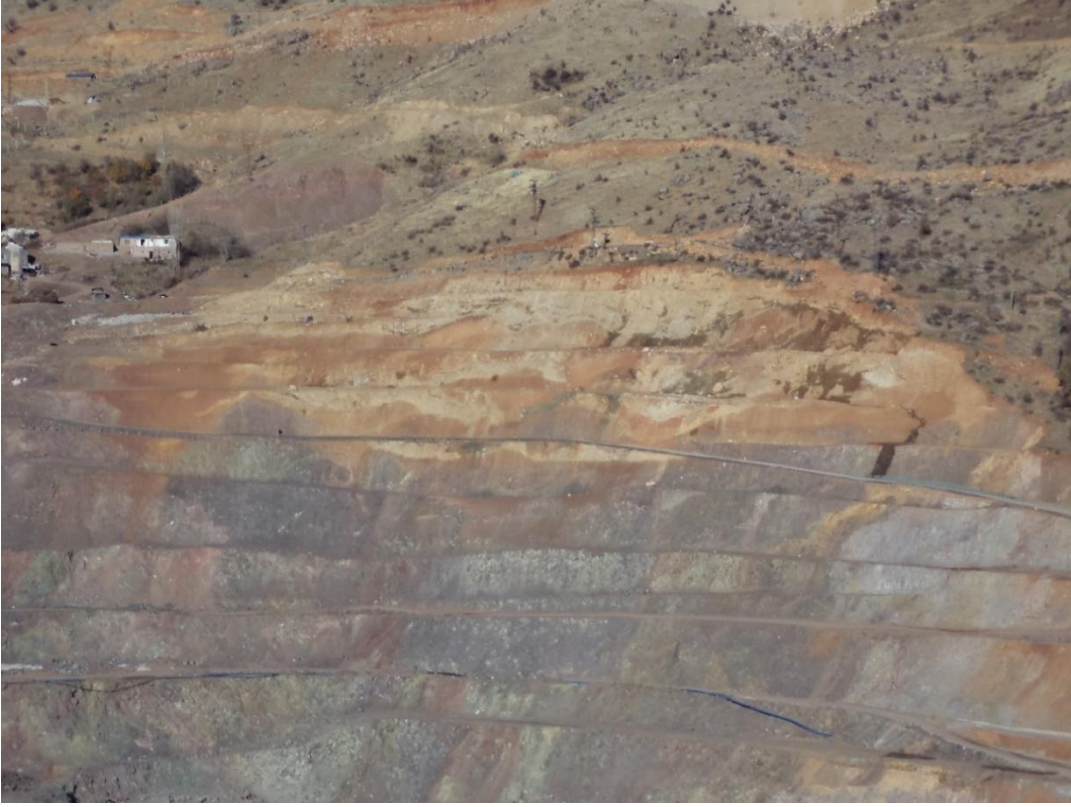
Şekil 3: Temmuz 2016 tarihinde şev kayması meydana gelen bölge. Kayma dolayısı ile akan toprak temizlenmiş, şevler yatırılmış, düzenli ve uygun bir kademelendirme ile güvenli hale getirilmiştir. Burada da sarı kahve renkli kesimde yeraltı suyu sızıntıları dikkat çekmektedir.
